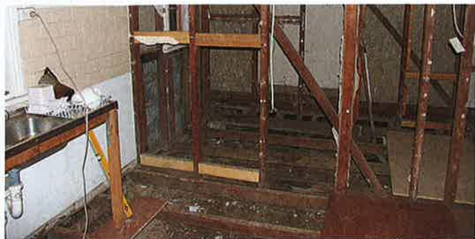
Bei der richtigen Haussanierung steckt viel Potenzial.
