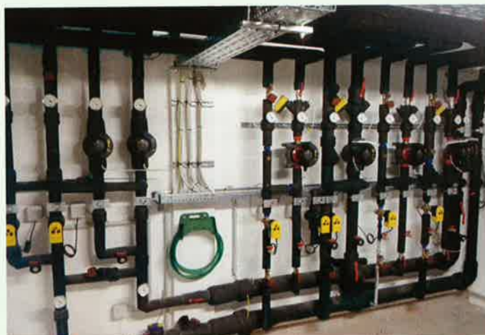
Heizung/Kälteverteilung im Technikraum
