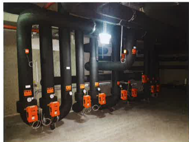
Der Hauptverteiler ermöglicht die Umleitung der Massenströme je nach gewünschtem Betriebszustand.
