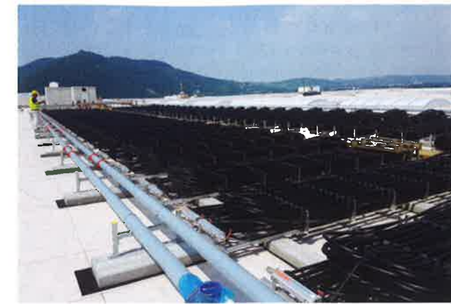
Neben dem Eisspeicher sind 172 Solar-Luft-Kollektoren mit insgesamt 73.000 Metern Rohrlänge – genügend Sonnenenergie und Umgebungswärme für einen ganzjährigen Betrieb zur Verfügung.
