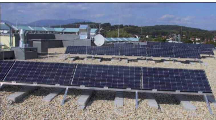
Photovoltaikanlage – prognostizierte Jahresleistung an Strom aus Sonnenkraft 5.000 kWh
