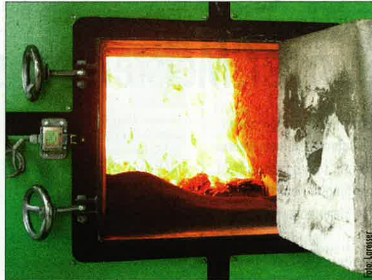
Die Effizienz von Feuerungsanlagen sollte man überprüfen lassen.
